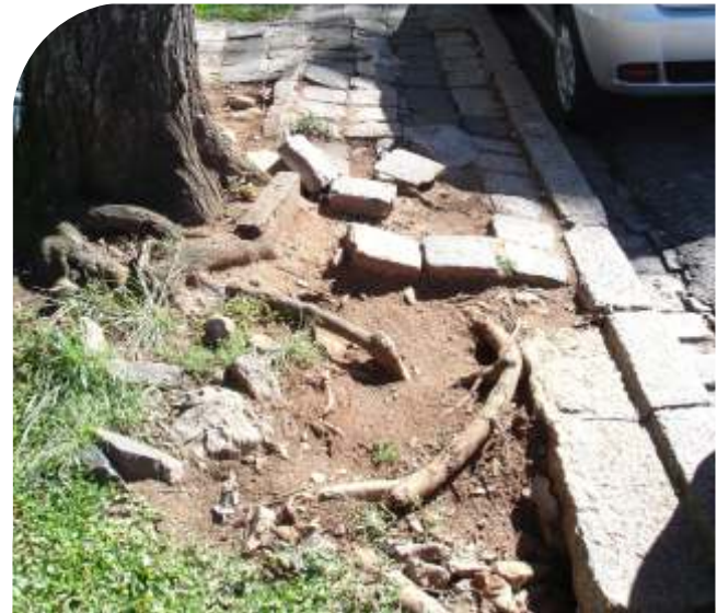
A melhor forma de evitar futuros danos às calçadas é a preparação de uma cova nas dimensões adequadas.
